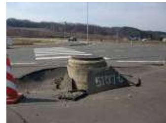
液状化の被害例 (上写真出典：「阪神・淡路大震災被害調査報告書」(社)建設コンサルタンツ協会)
