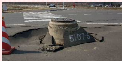
液状化によるライフラインの寸断(浦安市)
