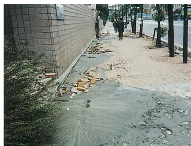
液状化による被害例
