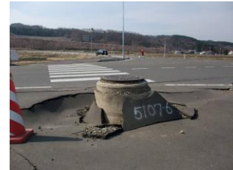
液状化の被害例
