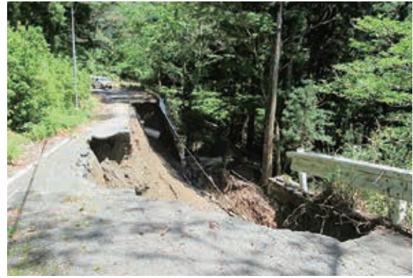
被災した林道天竜川線(天竜区水窪町奥領家)
