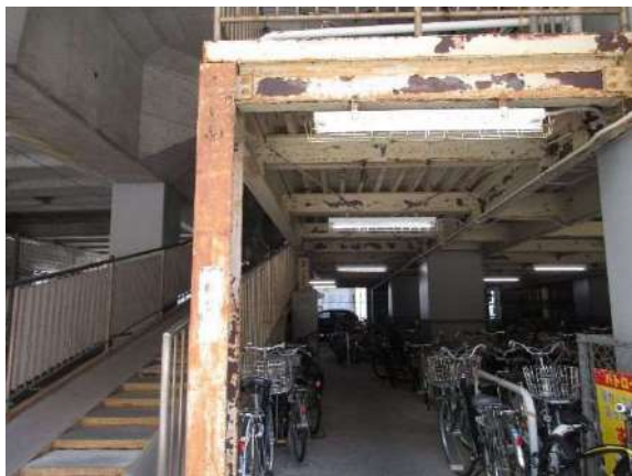
図 42- 駐車場施設の塗装の劣化状況
