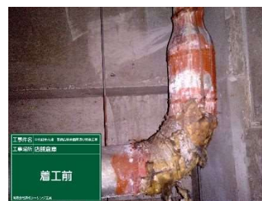
老朽化した設備系統
