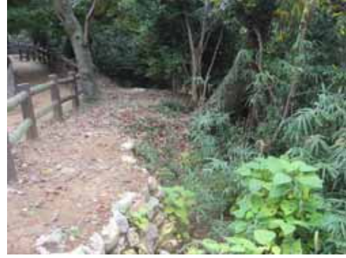
5 4と同様で樹木が影響して石垣の崩落が予想される。
