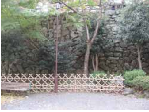
1 石垣の近景を疎外している。 日照不足である。
