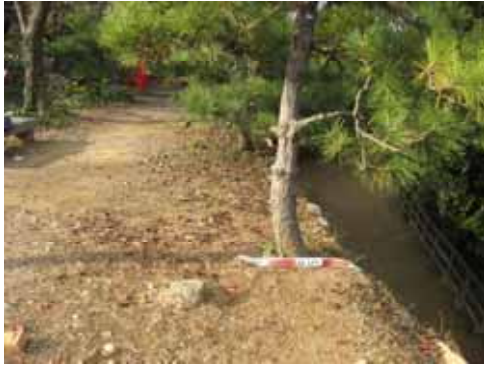
9 石垣端から約0.5mの位置にある。石垣裏込めに樹根が侵入し、裏込めを傷めている。
