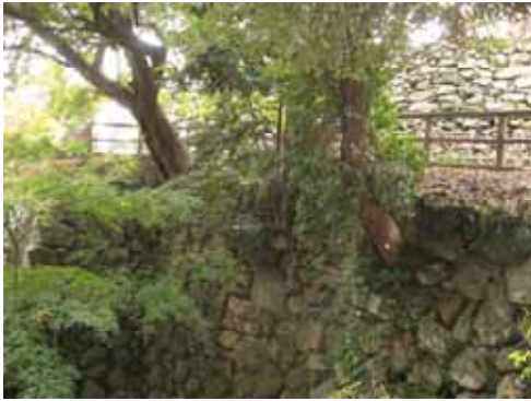
3 石垣上端に大きな負荷を与えている。風を含む振動で石垣が崩壊する可能性がある。
