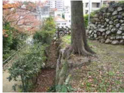
7 石垣上端を傷めるとともに、孕みの原因となっている。手前に伐採した樹根がある。
