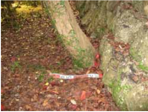
2 石垣基礎部に影響する。早急に伐採し樹根による障害を除去するとともに、日照を良くし石垣の劣化を防ぐ必要がある。
