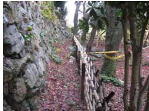
15 樹根が石垣基礎下に侵入している可能性が高い。日照が悪いのが過去に崩落した原因かもしれない。
