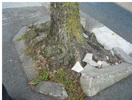
4.住吉バイパス 歩道の舗装を破壊する。
