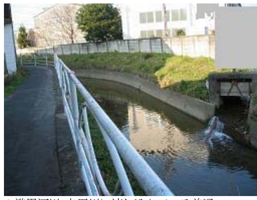
6.準用河川・曳馬川に流れ込んでいる普通 河川(排水路)上島 7 号線 3,039m (E-425-3-7)及び樋門
