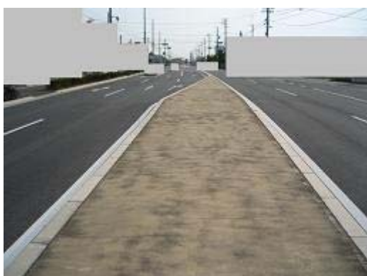
2.県道(浜北区)中央分離帯 植樹計画がなく、固められている。
