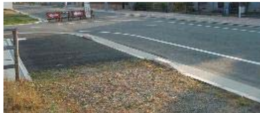
9.南浅田周辺区画整理区内 (工事中) 再々延長がされている。
