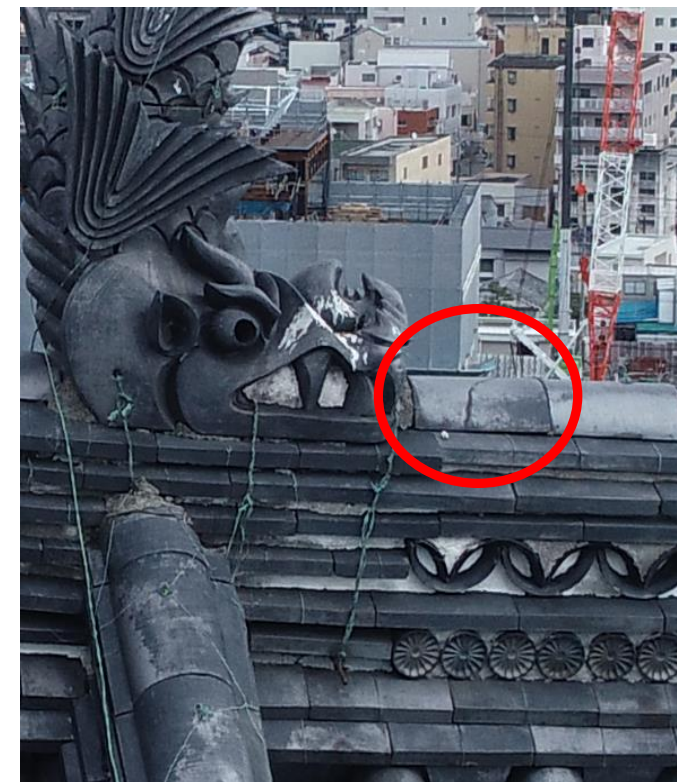
大棟冠瓦割れ
