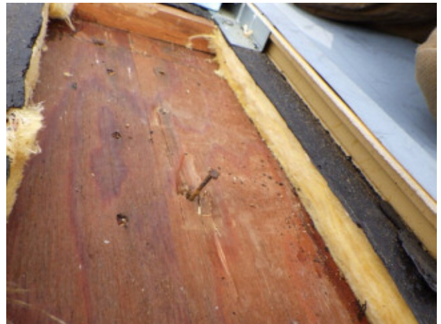
被災箇所以外の屋根を支える釘などの腐食
