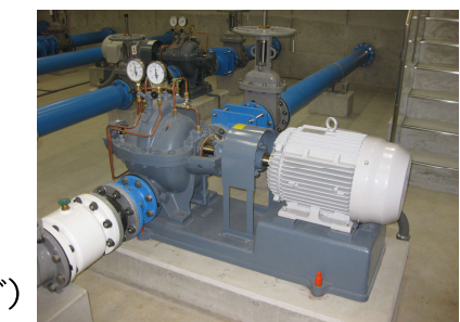
[参考] ポンプ設備
