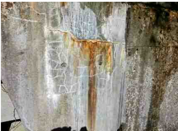
写真 3-1 区分Ⅲの損傷例 (ひびわれ、漏水・遊離石灰)
