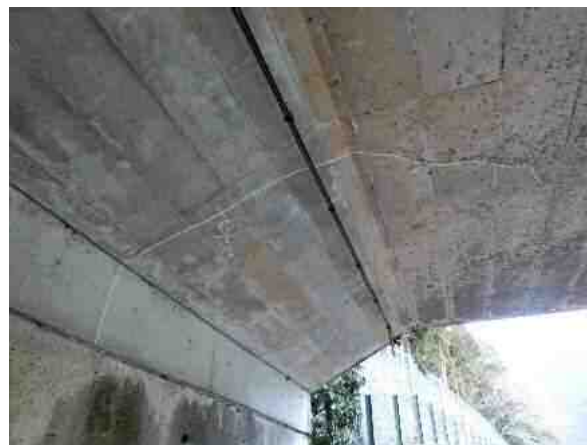
写真 3-2 区分Ⅱの損傷例 (ひびわれ)
