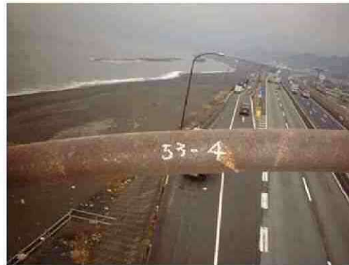
写真1 支柱本体の腐食事例
