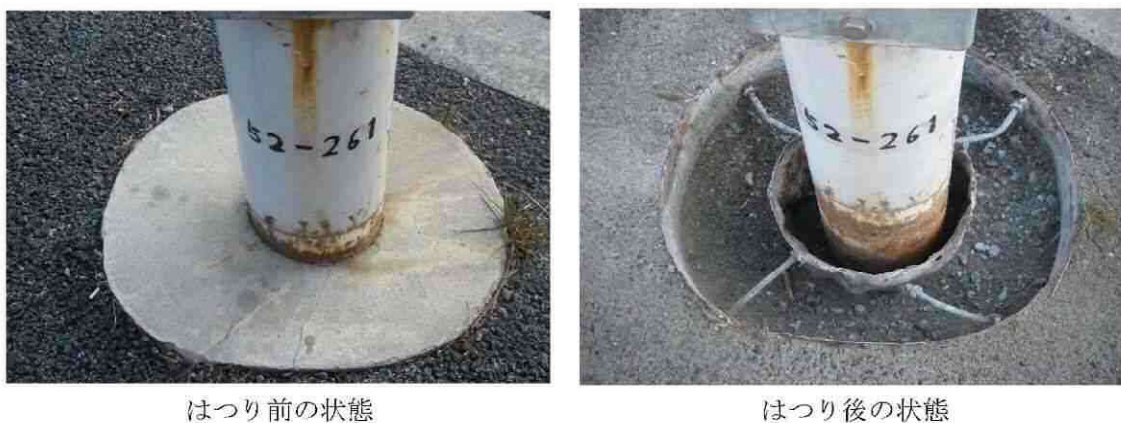
写真3 路面境界部の腐食事例(その2)
