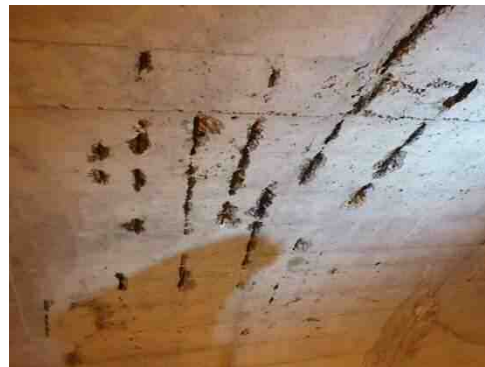
写真 3-2 区分Ⅱの損傷例 (鋼材腐食)
