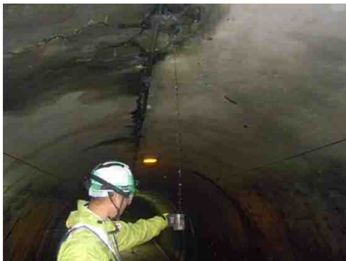
写真 3-1 区分Ⅲの損傷例 (漏水)
