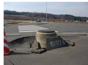
液状化の被害例
