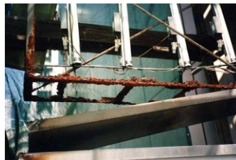
↑看板底部の脱落
