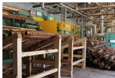
木質ペレット製造装置
