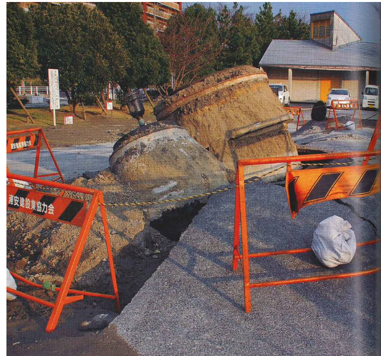
地震により下水道マンホールの浮き上がりが発生【東日本大震災】
