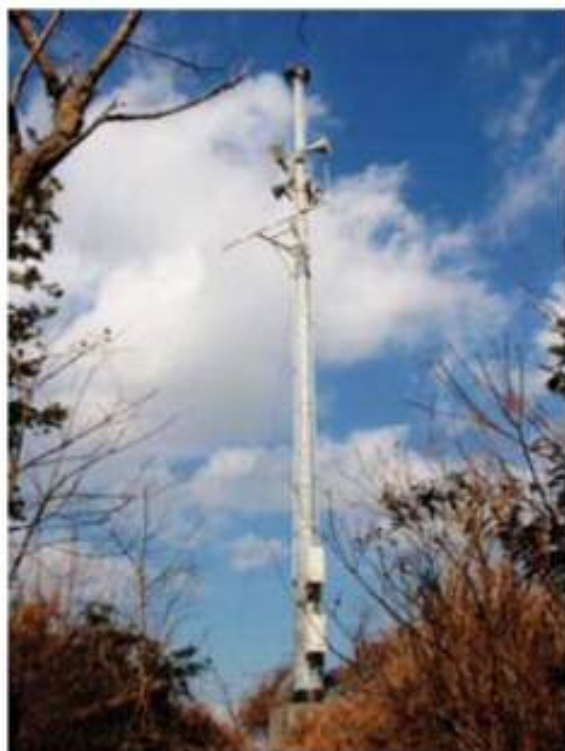
(同報無線屋外放送施設)
