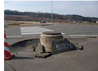
液状化の被害例
