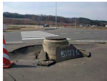
東日本大震災による液状化の被害例 （千葉県浦安市）
