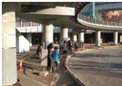
浦安市における地盤沈下の被害例
