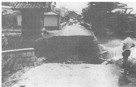
立谷川のはん濫による道路流出 (旧三ヶ日町平山,1974年)
