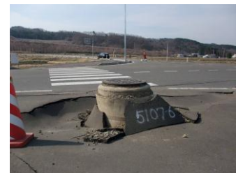
液状化の被害例
