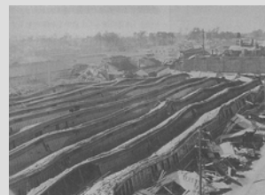
工場の倒壊の様子(高塚町)
