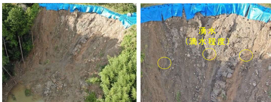
写真-4.1.2 2022/9/25(崩落翌日)の斜面状況
