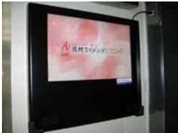
本庁舎 1階エレベーター乗場
