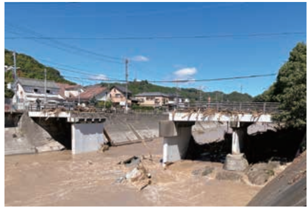
台風第15号で被災した天竜仲町山王線嘯月橋 しょうげつぼし
