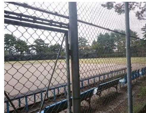
【第2球場】 防球ネット破損・腐食進行
