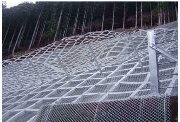
道路斜面对策
