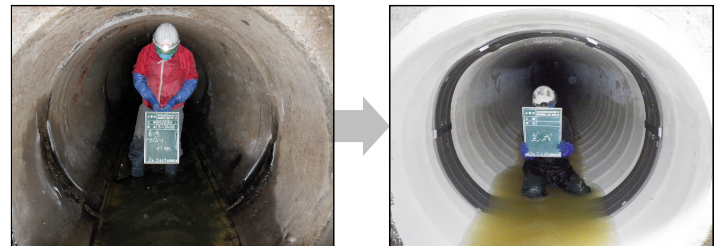
<改築前>老朽化した管路
