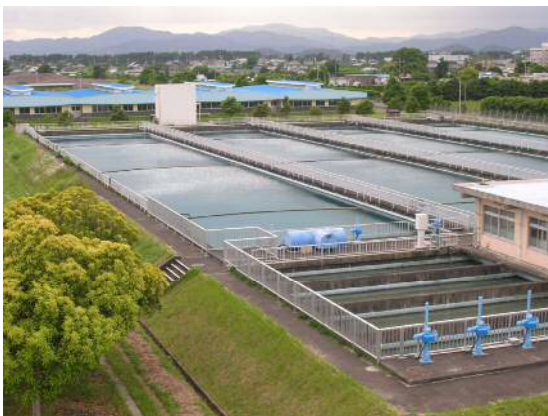
[参考] 浄水施設（沈澱池）
