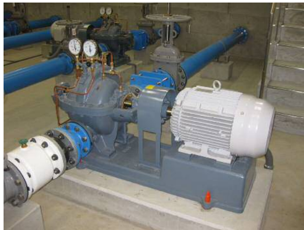
[参考] ポンプ設備
