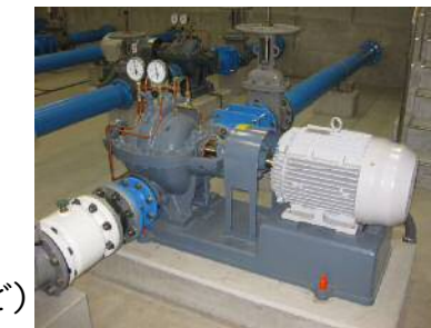
[参考] ポンプ設備
