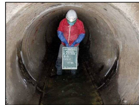
<改築前>老朽化した管路
