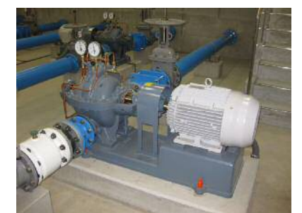
[参考] ポンプ設備
