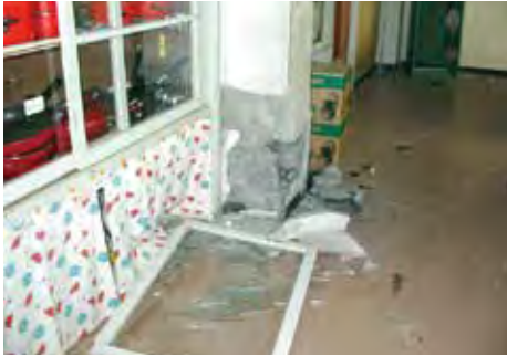
事例① ガラスの破損
