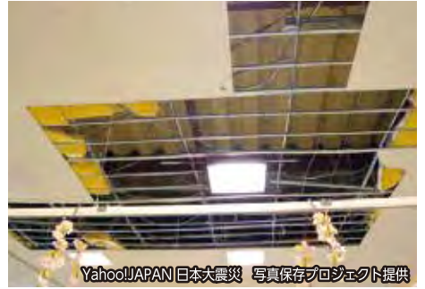
事例③ 天井材の落下
