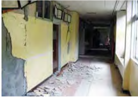
事例② 壁のはくり
