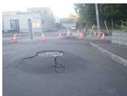
■ 平成30年北海道胆振東部地震の被害状況
